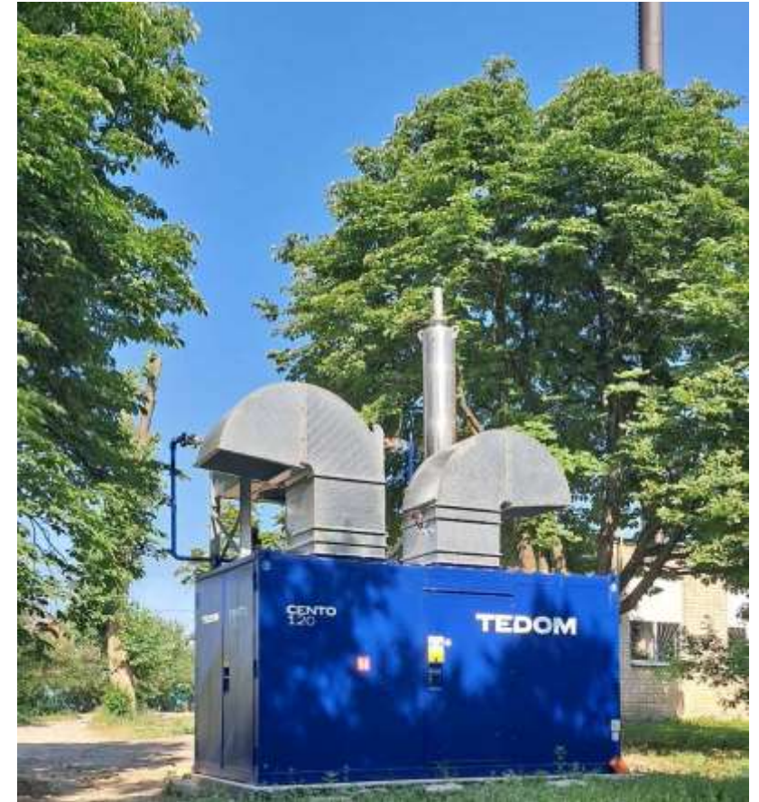
КОТЕЛЬНЯ 7, ВУЛ ПАРКОВА 1В
