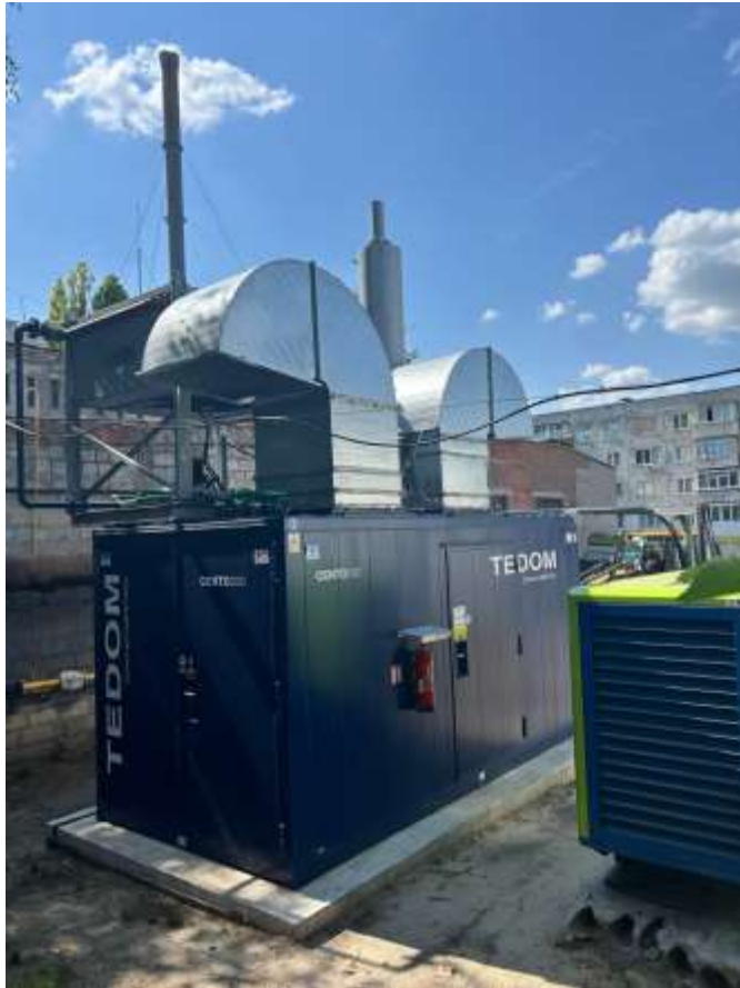
КОТЕЛЬНЯ 1, ВУЛ. КОЖЕДУБА 5 А
