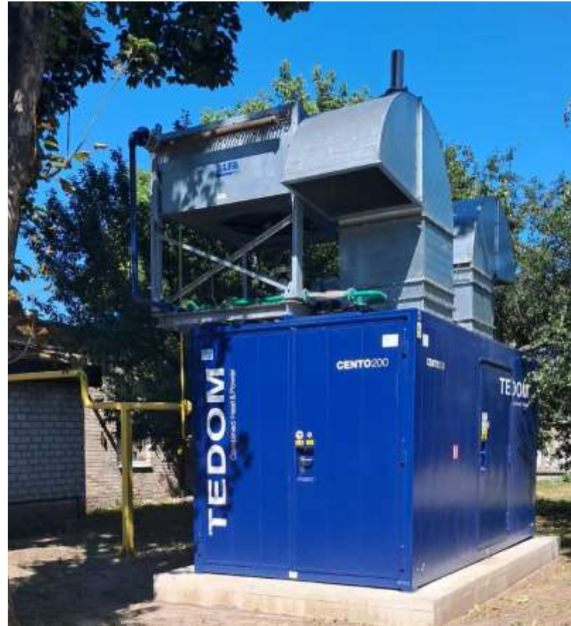
КОТЕЛЬНЯ 6, ВУЛ. СТАДІОННА 23А
